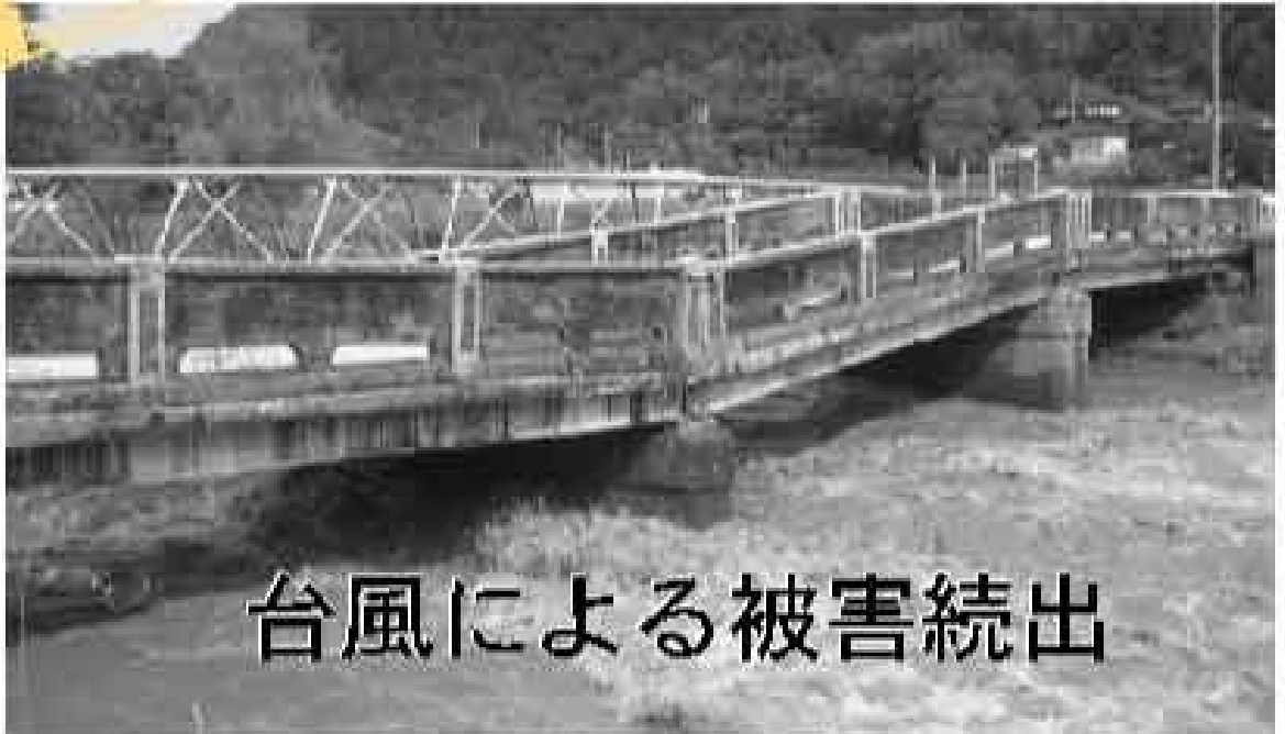
唐木沢橋 橋脚洗掘沈下
