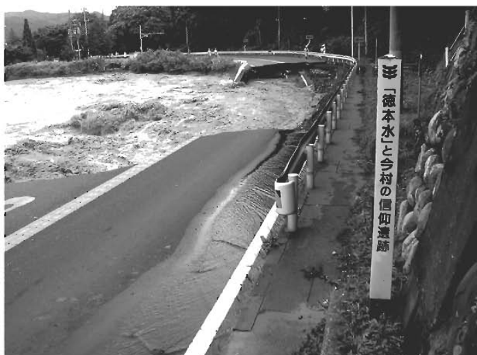
国道153号線／流失現場
