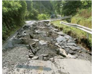
沢底 7月豪雨災害現場
