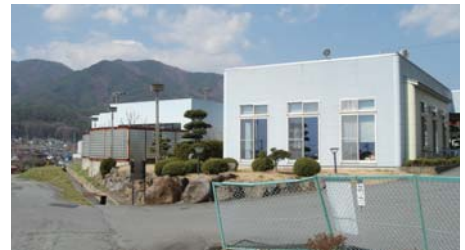
老朽化対策が必要な湯にいくセンター
