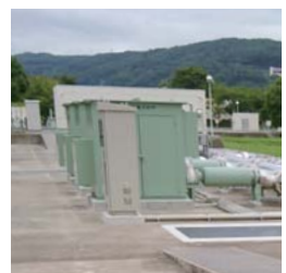
辰野水処理センター
