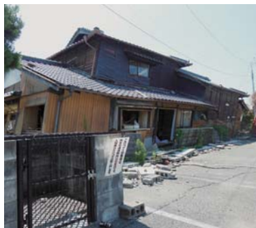
熊本ブロック塀倒壊状況
