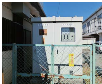
西小高圧受電設備
