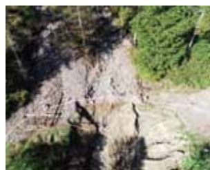
林道西部線3号箇所
