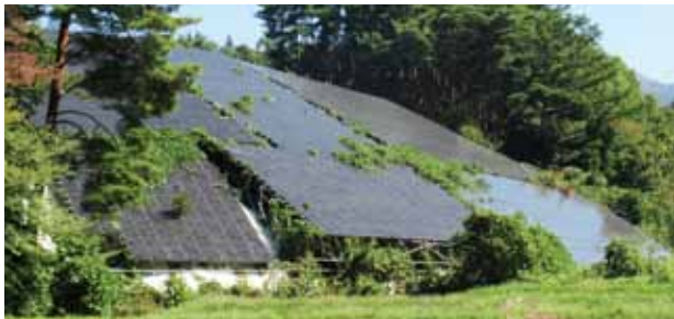
樹木を伐採した斜面に設置されたパネル (県内)
