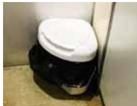
庁舎内に設置されたサニタリーボックス
