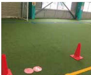
ほたるドーム雨漏り
