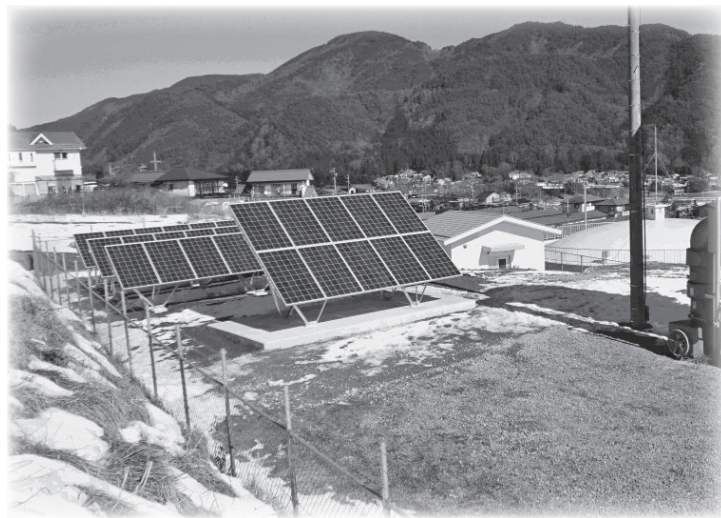
湯舟配水地の太陽光パネル
