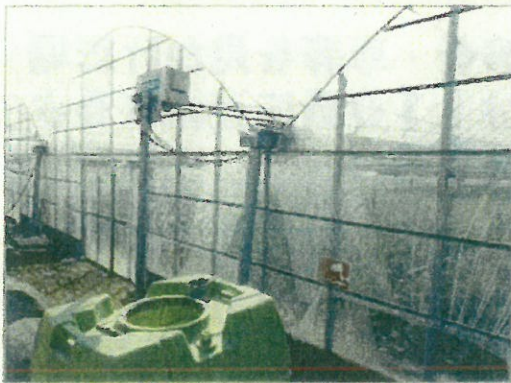
防犯カメラの設置
