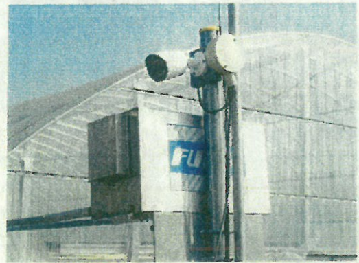
防犯カメラの設置
