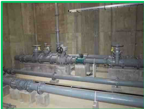
湯舟配水池:緊急遮断弁設備
