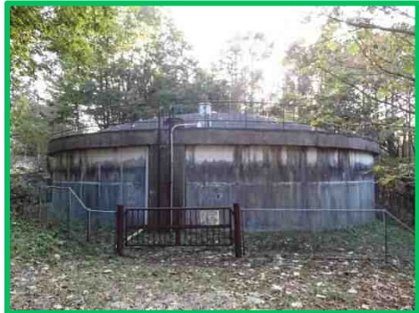
井出の清水配水池
